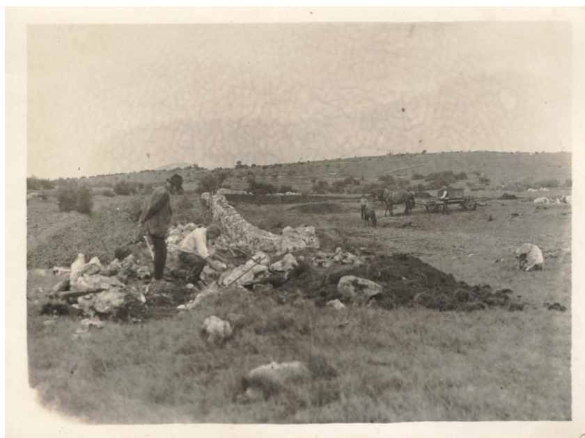
Na sliki graditev suhega zidu v okolici Palškega jezera (Foto: Arhiv Edmund Srebot, Petelinje)
